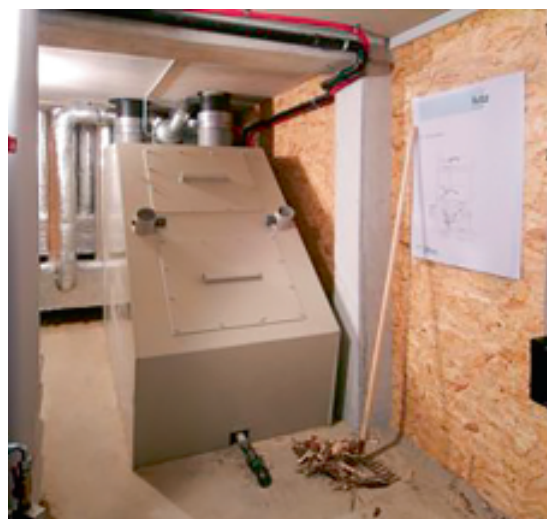
Bien que le site de Green offices compte 56 employés, le digesteur ne nécessite que 2 à 3 vidanges annuelles.
